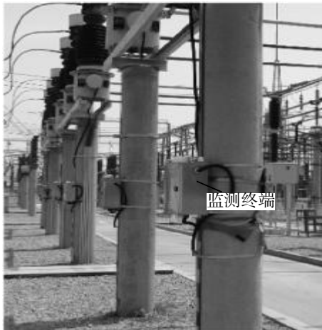
图 8 监测终端现场安装图
